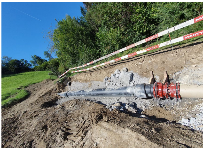
Druckleitung Kraftwerk Tobel
