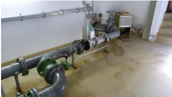
Pumpstation Seidenbaum: Zusammenschluss Quellwasser Azmoos mit dem Hydrantennetz Trübbach (entstanden aus dem Vertrag nach dem Kauf der Oberbachquelle durch Azmoos (2/3) und Trübbach (1/3) des Kaufpreises).
